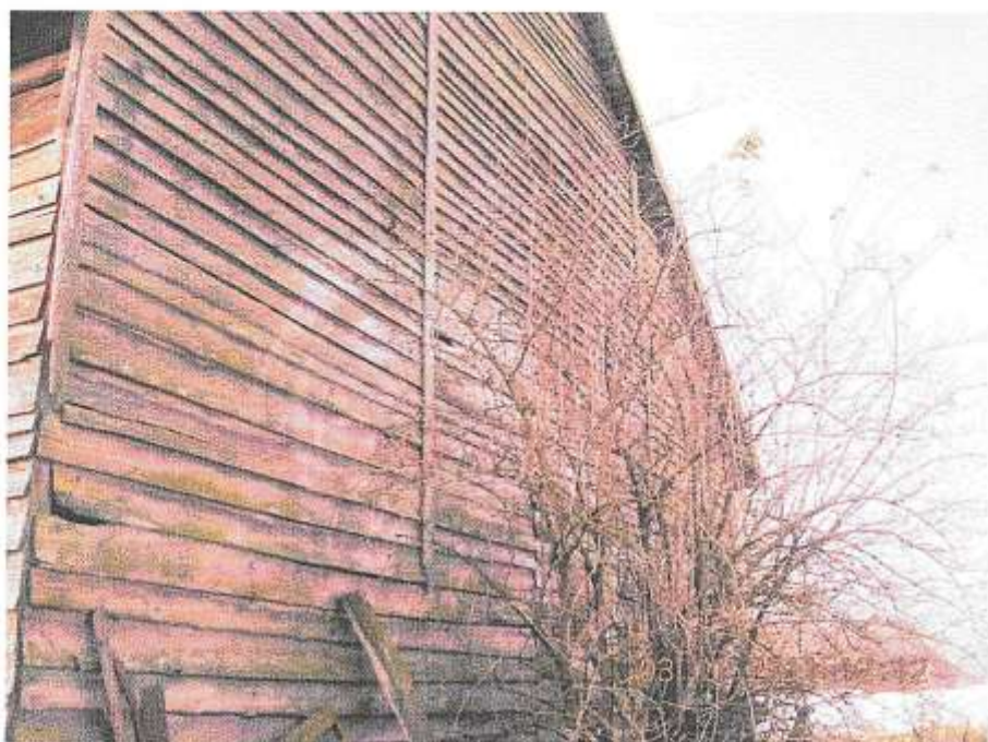
Fot.11 zniszczone deski wiatrowe (narożnikowe) Młynowo 38. Podobne zniszczenia występują we wszystkich przedmiotowych obiektach.
