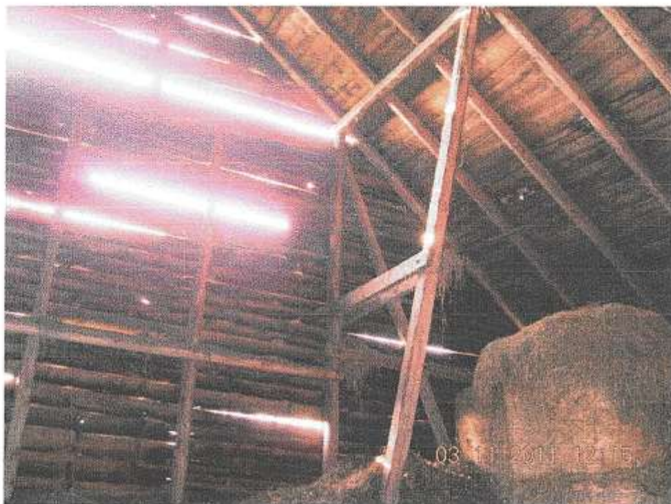
Fot. 9 Deskowanie ściany szczytowej stodoła Młynowo 38 Podobne zniszczenia występują we wszystkich przedmiotowych obiektach.
