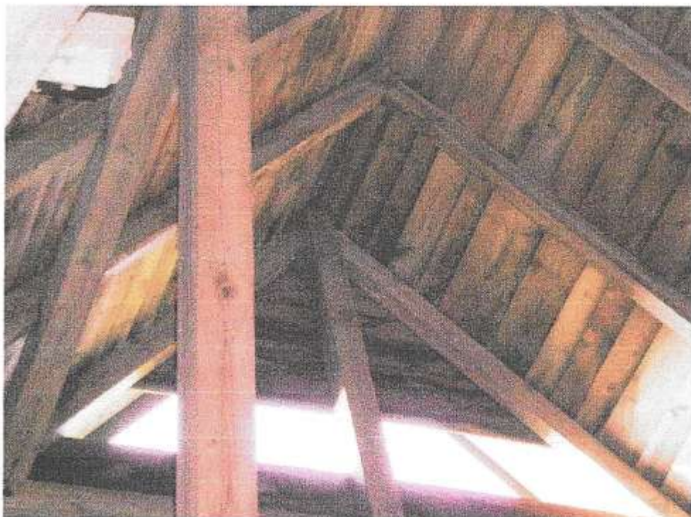
Fot. 7 Uszkodzone deskowanie szczytu stodoła Jarzeń 11
